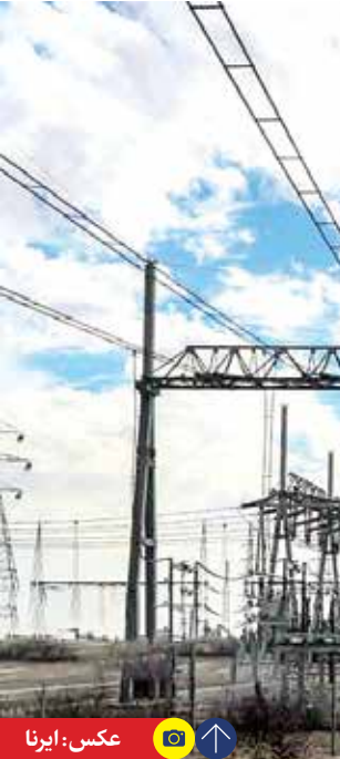
نمای کلی از یک ایستگاه نیروگاه برق در ایران. عکس: ایرنا
