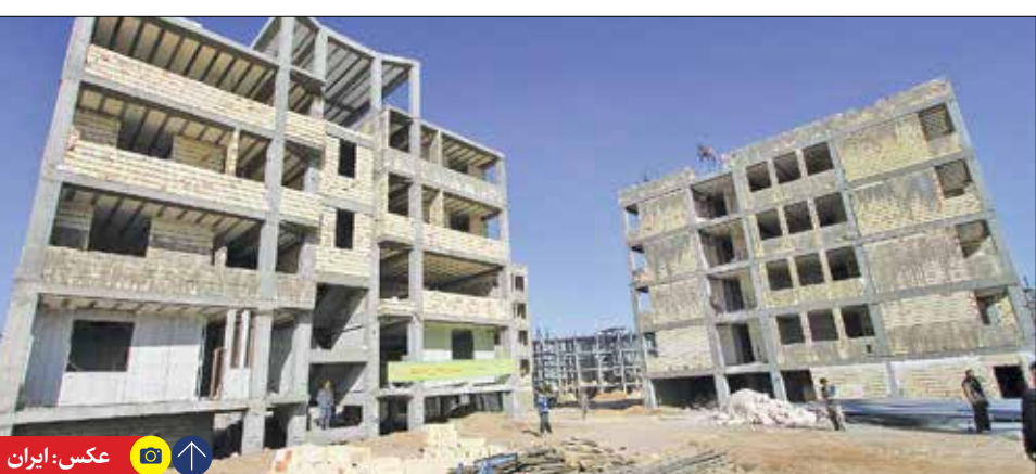
راستا هفته گذشته در شهرهای جدید پزند، هشتگرد، ایوانکی و سهند، واگذاری زمین انجام شده است و در شهرهای جدید
